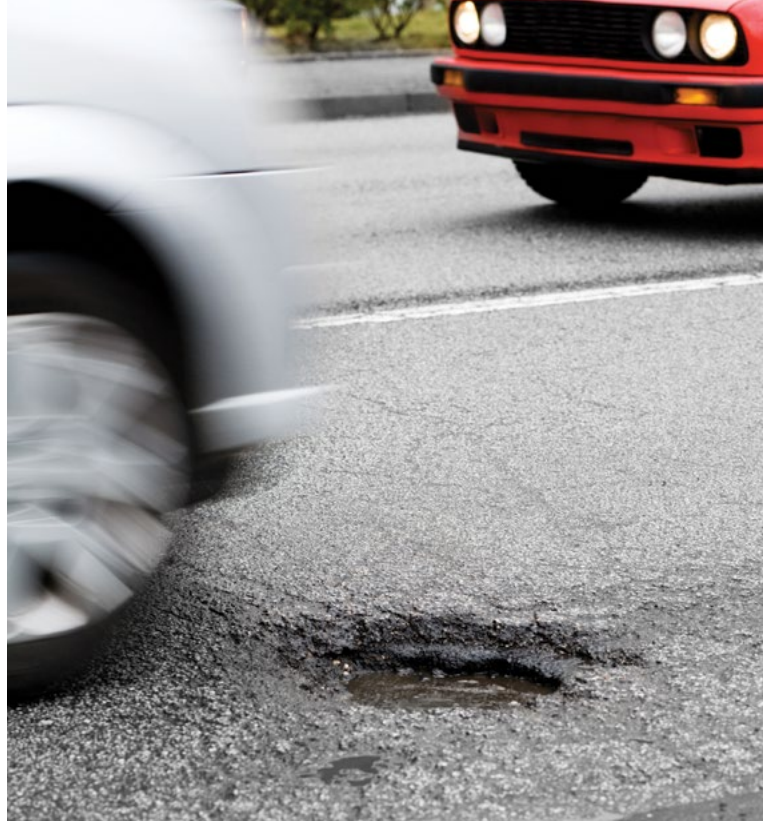
Los subsidios federales ayudan a las ciudades a reparar baches y otros daños viales en las municipalidades de los EE. UU. Crédito: Justin Sullivan/Getty Images
